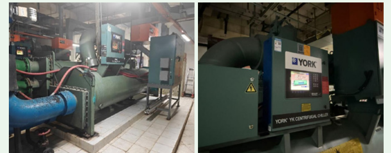
冷水机组改造前后
